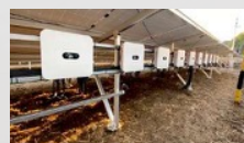
設備運転管理
