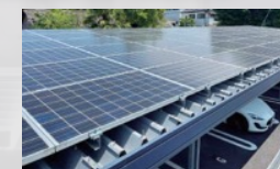
自家消費／カーポート 容量：DC99.84kWAC49.5kW
