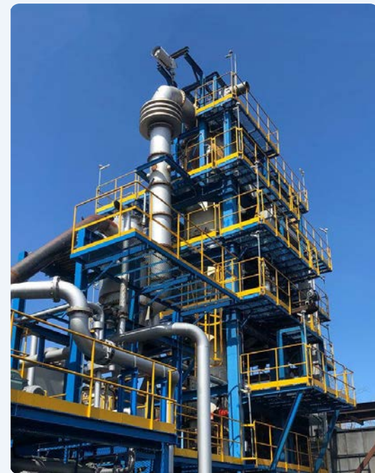
石狩バイオマス発電所
