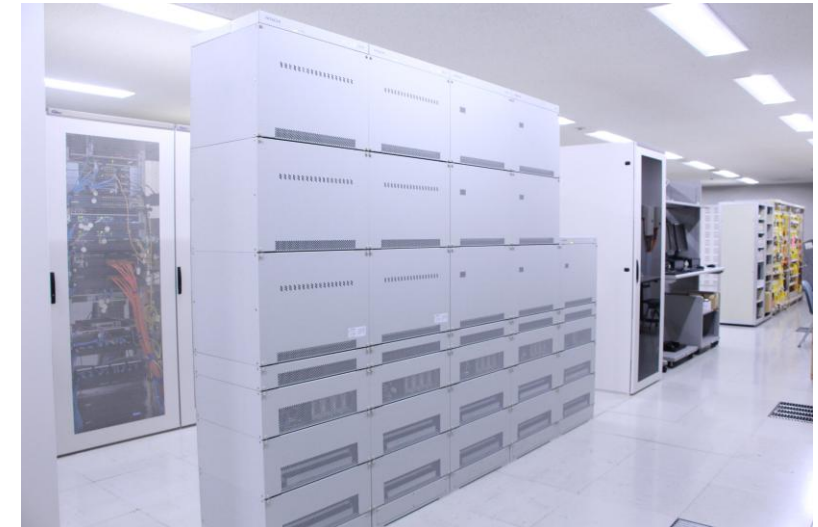
羽田空港共用通信サーバー
