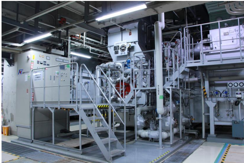
羽田空港ボイラープラント
