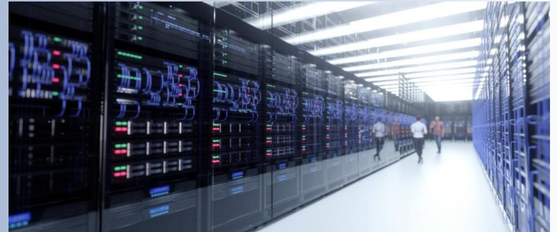
データセンター (出典元：ソフトバンク)
