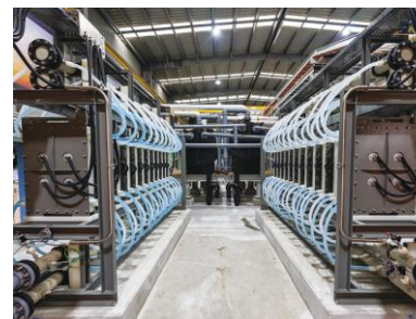
バナジウム電解液の製造の様子（Vecco社製造設備）
